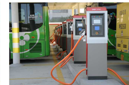
光伏一体智能充电站
