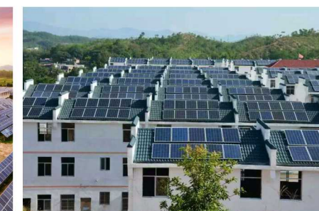
江西扶贫光伏项目
