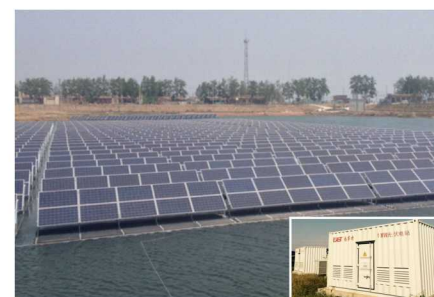
亚洲最大水面光伏电站
