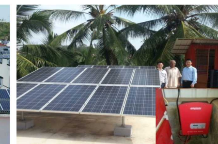
印度离岛发电站项目
